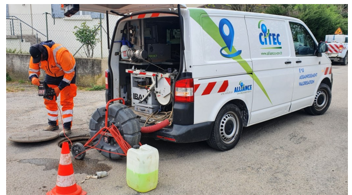
Intervention de la CITEC pour curage du réseau assainissement dans le cadre du marché de hydrocurage.
