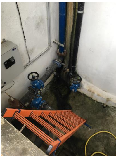
FIGURES 6 – PHOTOS INTERIEUR STATION DE POMPAGE
