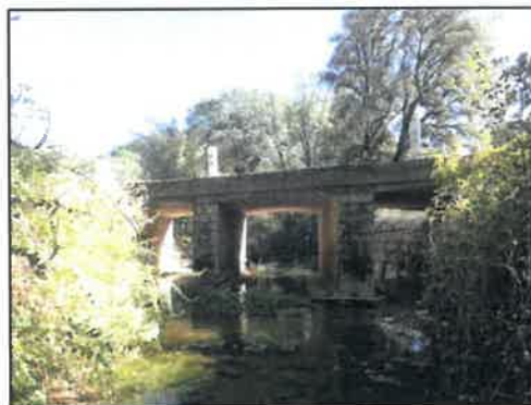
Exemple d'ouvrage sur l'Avenç à changer pour éviter les embâcles et les débordements ou les érosions au niveau de la D9E2
