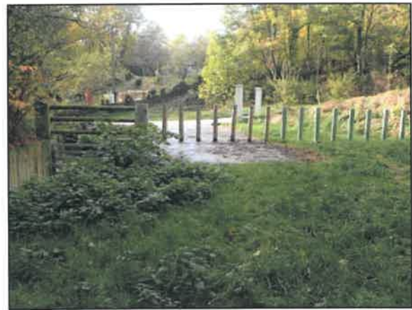
ouvrage filtrant sur la totalité de la section d'écoulement du Ravin à l'amont d'une section busée— les pieux sont associés à une grille horizontale placée directement dans le cunette béton (...)
