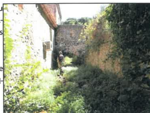
exemple d'ouvrage risquant d'être à l'origine d'un embâcle dans la traversée de St-Guilhem du Désert
