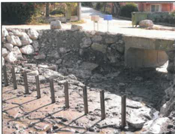
ouvrage filtrant implanté perpendiculairement aux écoulements et 15 m à l'amont d'un pont sur le Malguéri dans la Drôme— les pieux sont espacés d'1 m
