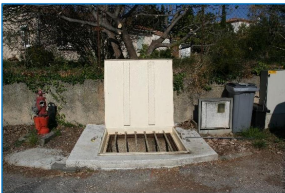
Poste de relevage – St Jean-de-Fos
