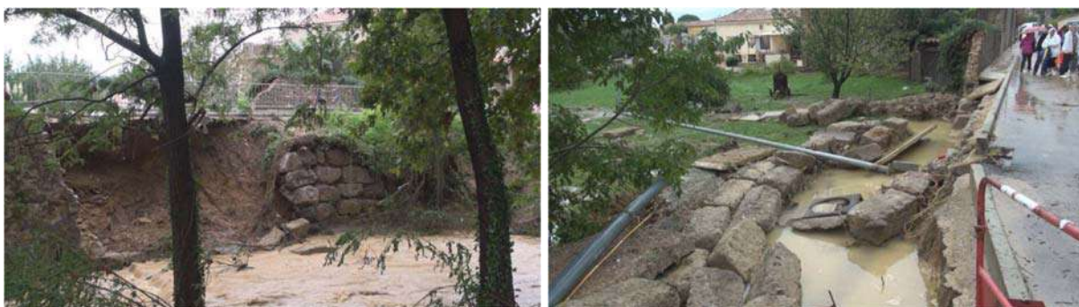
Mur de soutènement de la RD123, en amont de l'ouvrage, à la décrue / Effondrement du mur en rive droite du Lussac, à l'aval immédiat de la RD123
