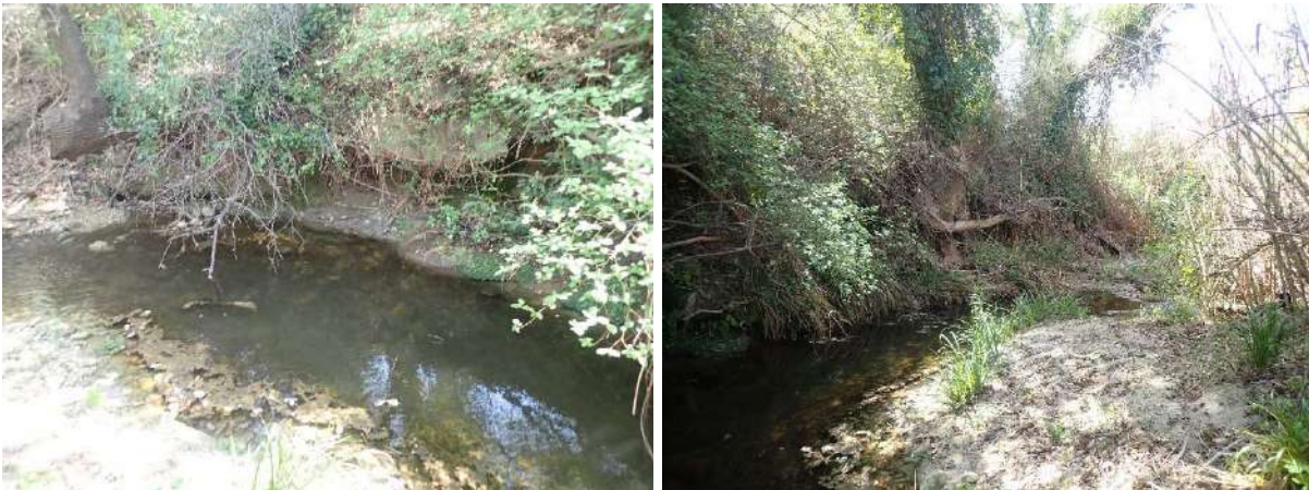
Figure 113 : Arbres rendus instables par l'érosion de berge en extrados de coude
