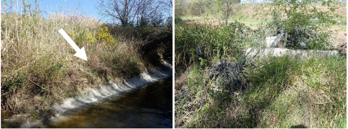
Figure 110 : Erosion de glissement en rive gauche et déchets en haut de berge
