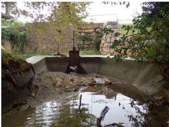
Figure 28 : Lavoir provoquant un envasement (Lussac)
