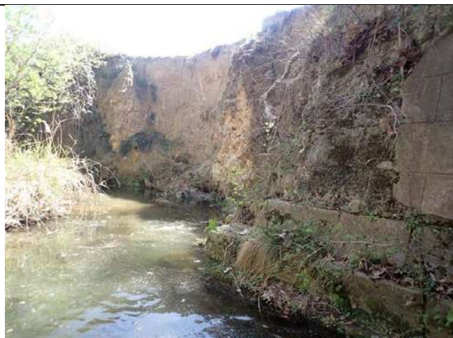
Vue de l'érosion en amont du mur de berge rive gauche
