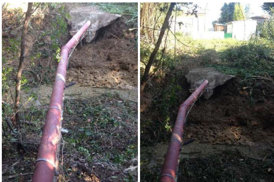
Figure 15 : Conduite EU traversante endommagée par la crue de 2014
