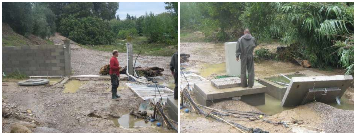
Figure 16 : Dommages sur le poste de relevage des eaux usées (en aval du village)
