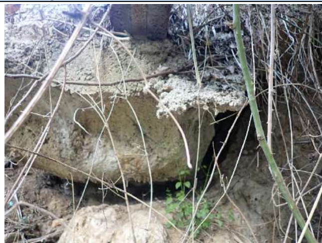
Vue de l'affouillement rive droite
