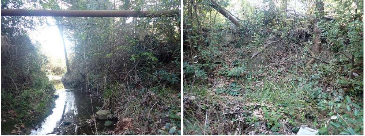
Figure 102 : Conduite d'eaux usées traversant le lit en hauteur
