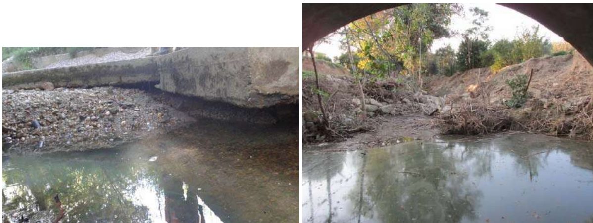
Figure 6 : Photos de dégâts de la crue de 2014, CG34
