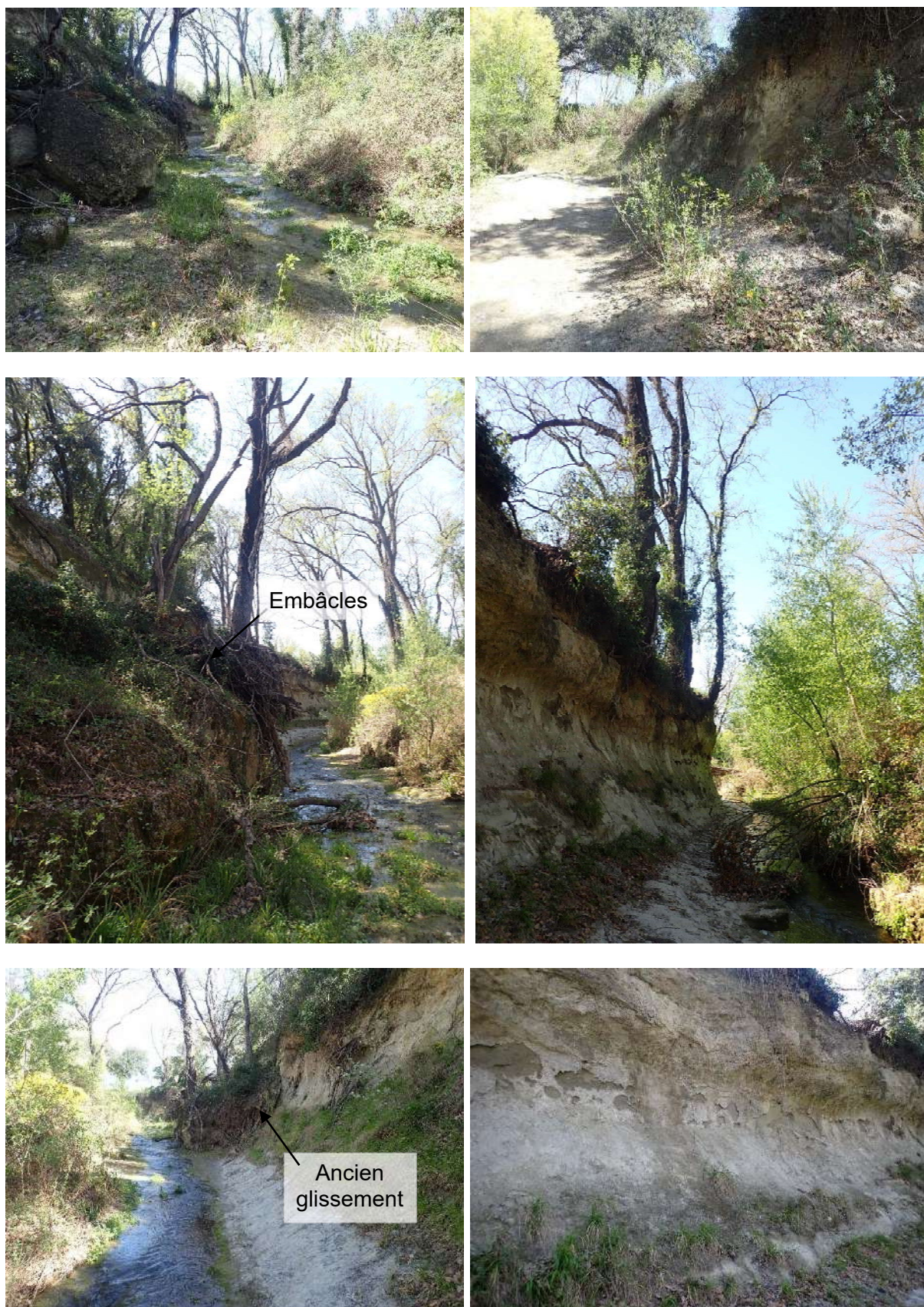
Figure 120 : Lit encaissé du ruisseau de Lussac dans les limons de l'Hérault avec des affleurements marneux en fond de lit
