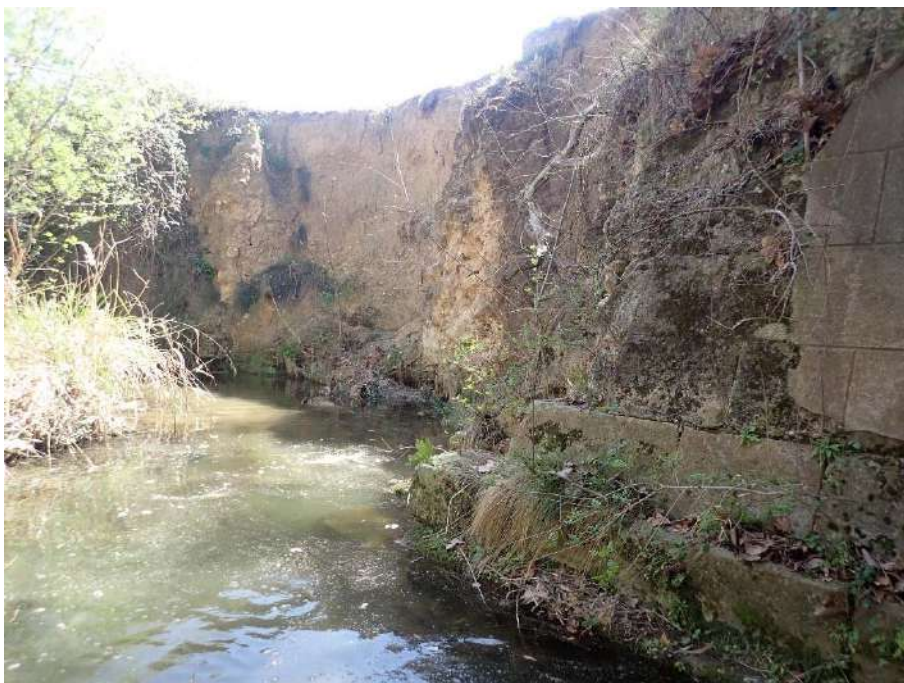
Figure 131 : Vue de l'érosion active en amont proche du pont de la RD32
