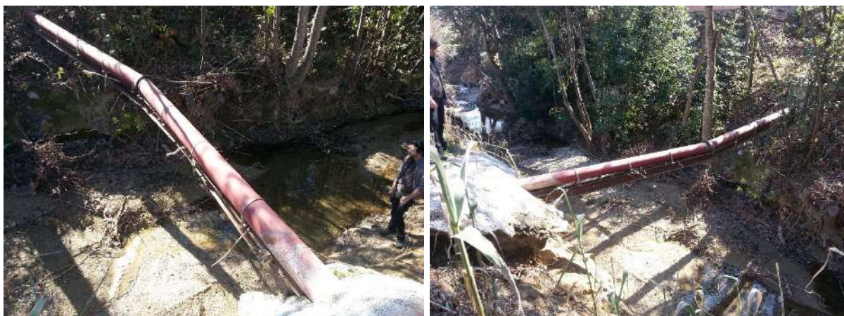
Conduite traversante principale d'eaux usées endommagées
