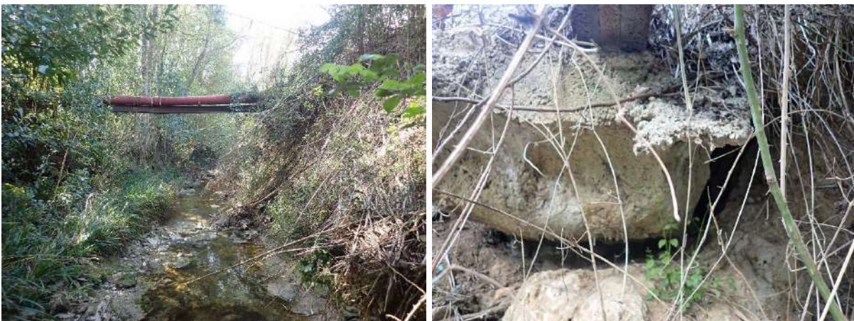
Figure 95 : Conduite primaire d'eaux traversant le lit du ruisseau de Lussac avec un ouvrage en mauvais état
