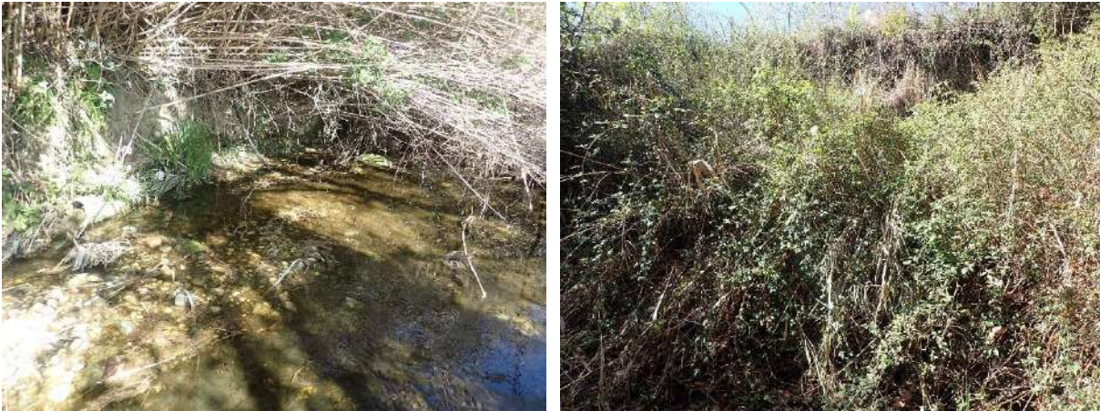
Figure 112 : Erosions de berge rive droite en aval de la station de relevage
