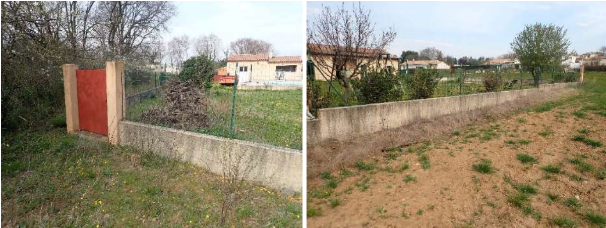
Figure 69 : Mur de propriété en lit majeur rive droite du ruisseau de Lussac
