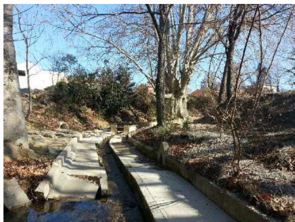
Berge et dalle de fond endommagées entre le lavoir et le pont RD123
