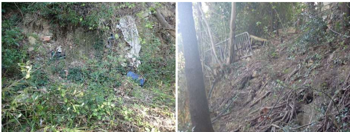
Figure 99 : Gravats, déchets et barrières sur la berge rive gauche, faible érosion de talus non végétalisé avec mise à nu des racines d'arbre
