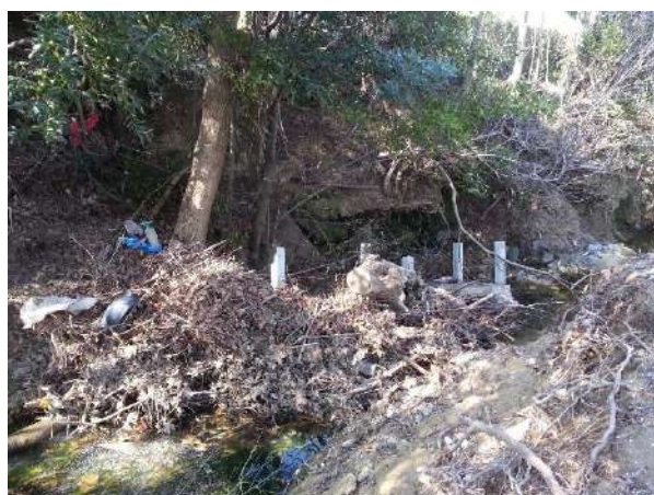
Passerelle béton emportée dans le lit vers l'aval du village
