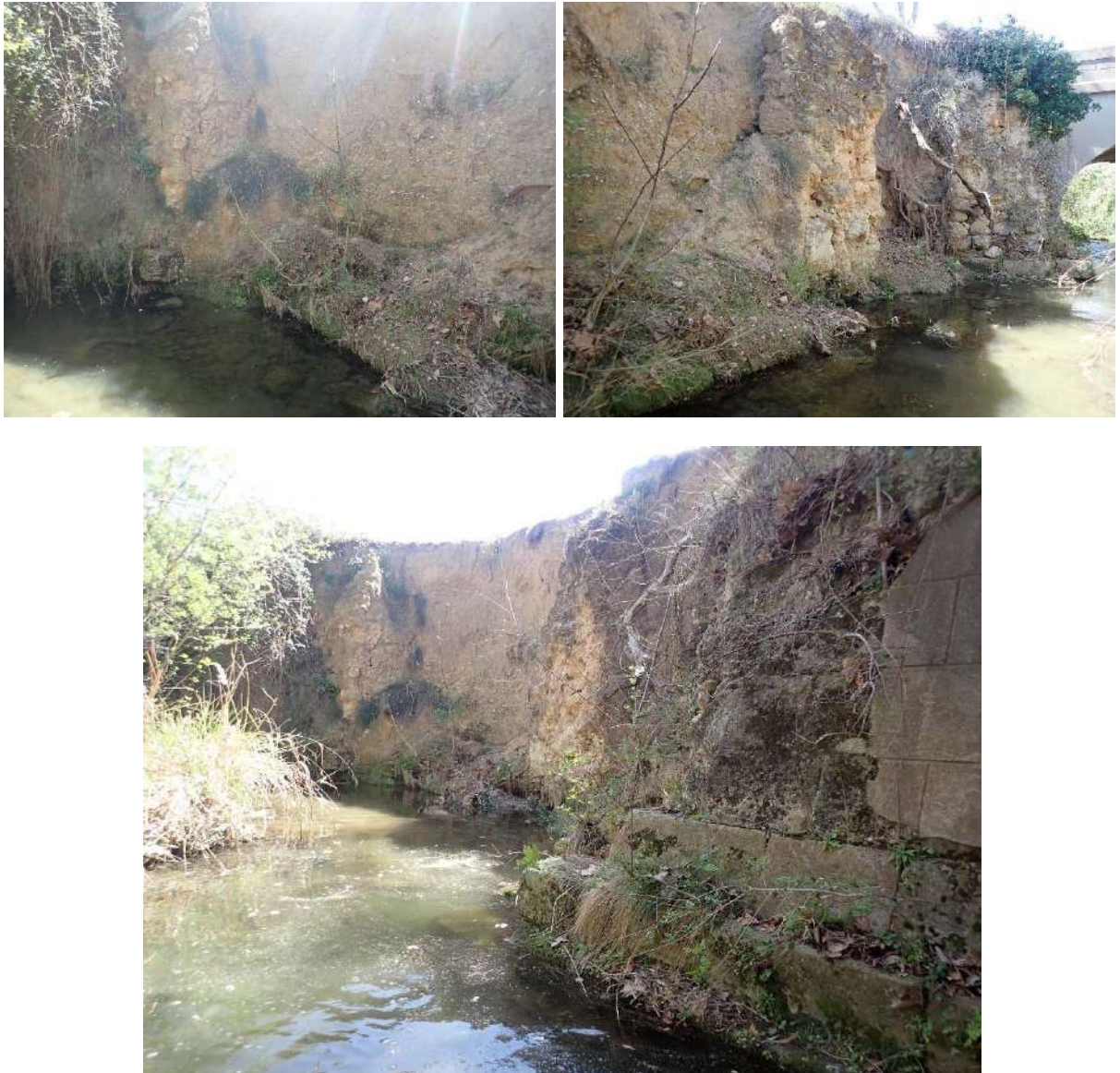
Figure 116 : Effondrement passé du mur de berge rive gauche en amont du pont de la RD32
