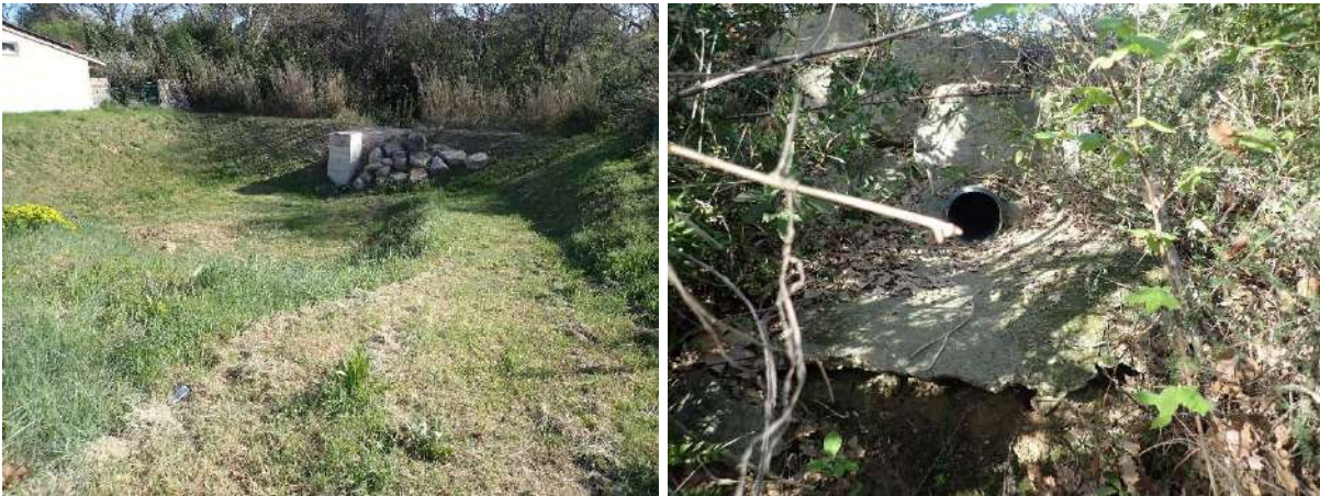
Figure 84 : Bassin de compensation à l'imperméabilisation des sols
