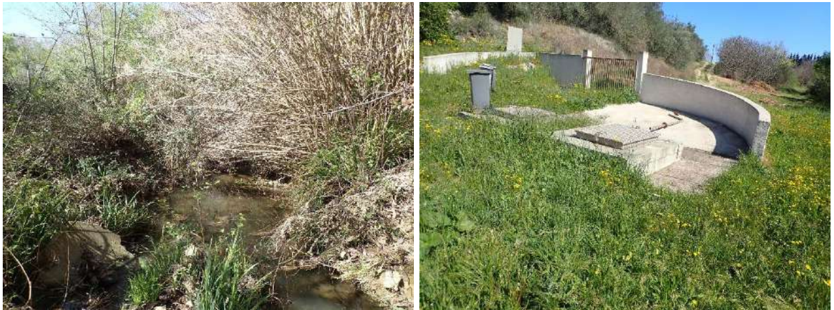
Figure 111 : Lit obstrué par les cannes de Provence / Station de relevage des eaux usées en rive droite
