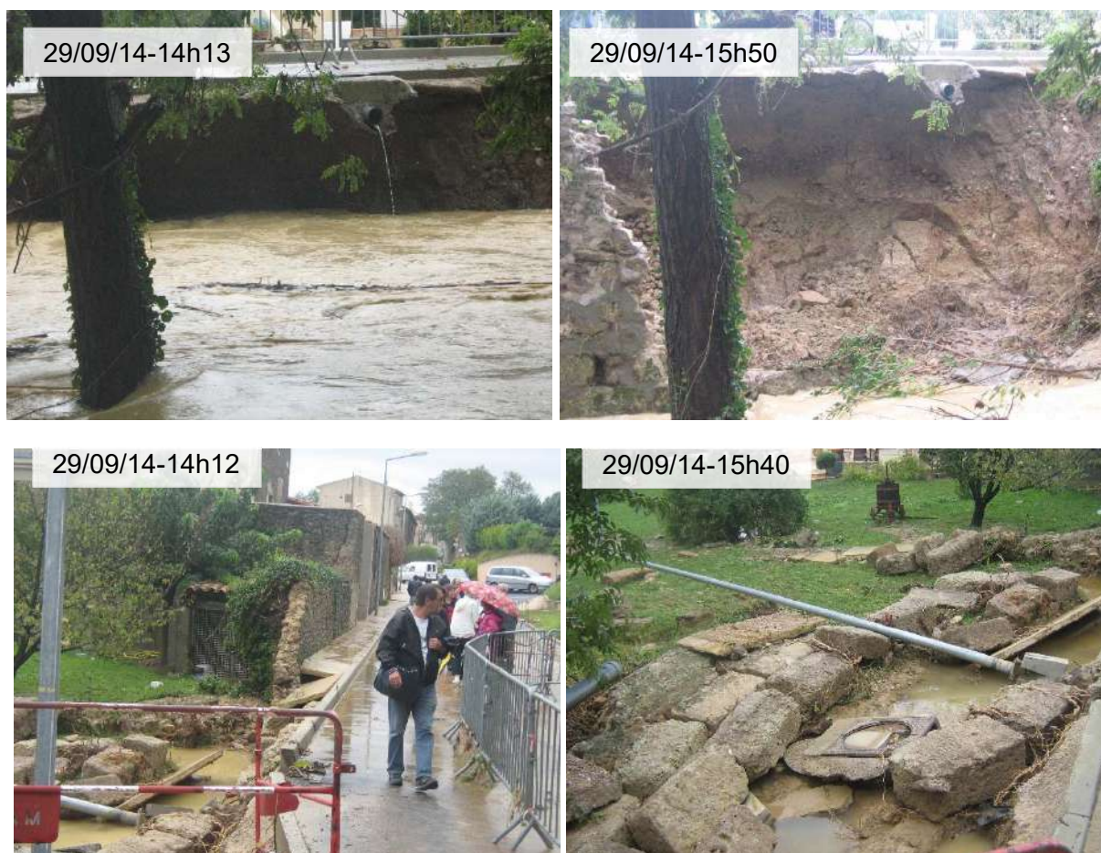
Figure 11 : Murs amont et aval rive droite tombés du pont de la RD123 lors de la crue de 2014
