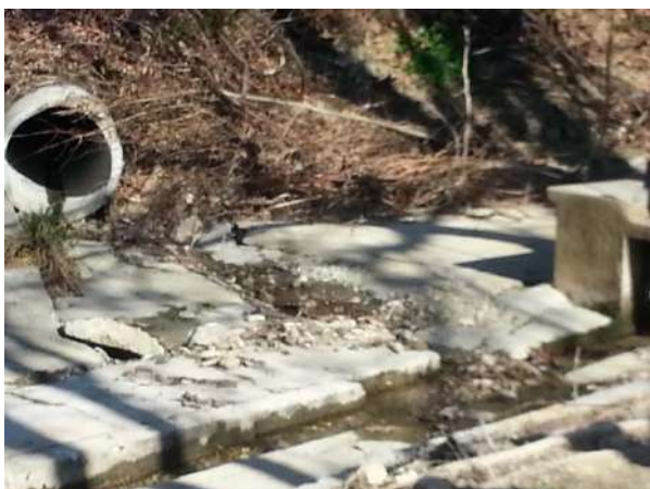
Dalle de fond endommagée en aval du lavoir
