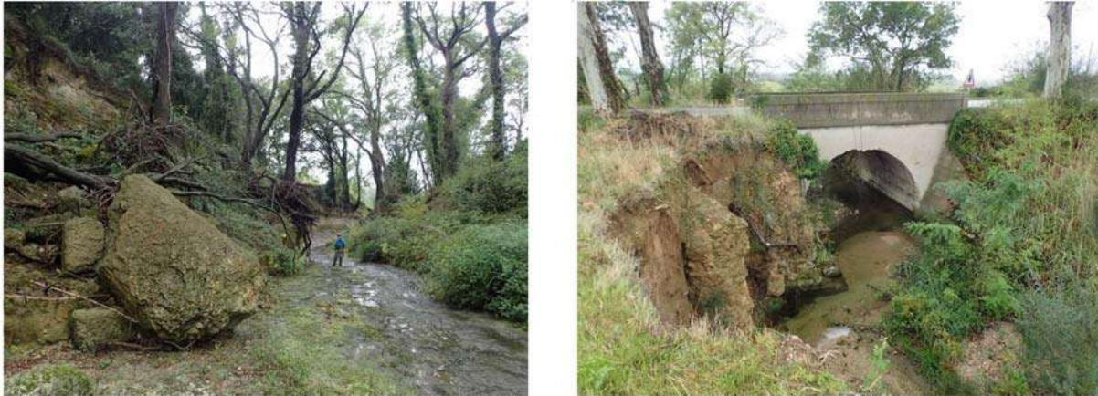
Figure 26 : Forte incision du lit du Lussac sur sa partie aval / Erosion menaçant le pont de la D32 suite à la crue de 2014 (Lussac)
