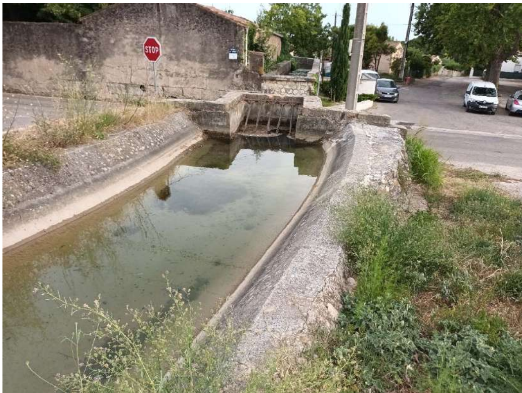
Figure 45 : Vue du siphon inversé du canal d'irrigation sous l'Avenue de Canet – route D123E1A
