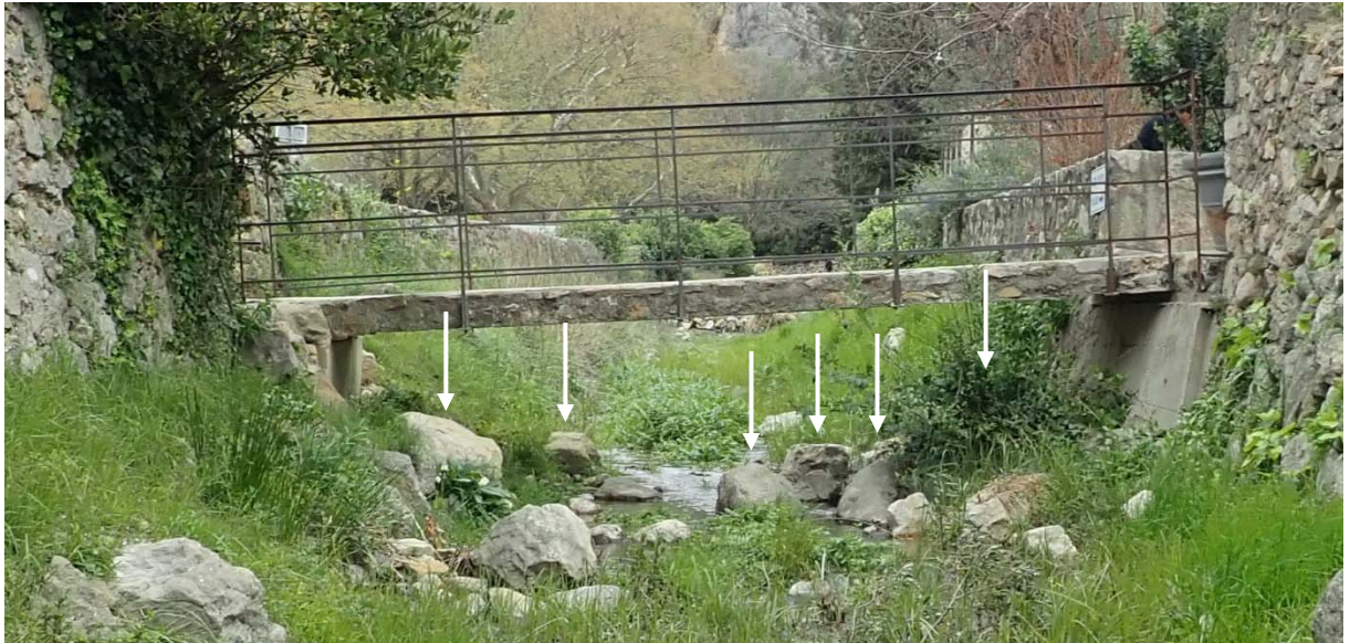
Figure 19 : Blocs et végétation limitant la section d'écoulement sous la passerelle amont
