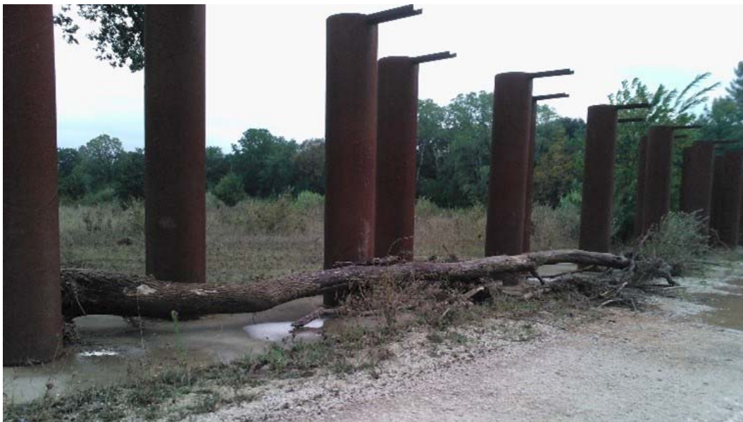
Figure 16 : Exemple de pieux acier avec dispositif additionnel de retenue des flottants en cas de surverse des pieux
