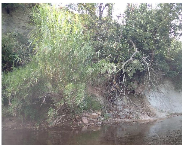
Dépôt de décombre et remblai en berge (ID13)
