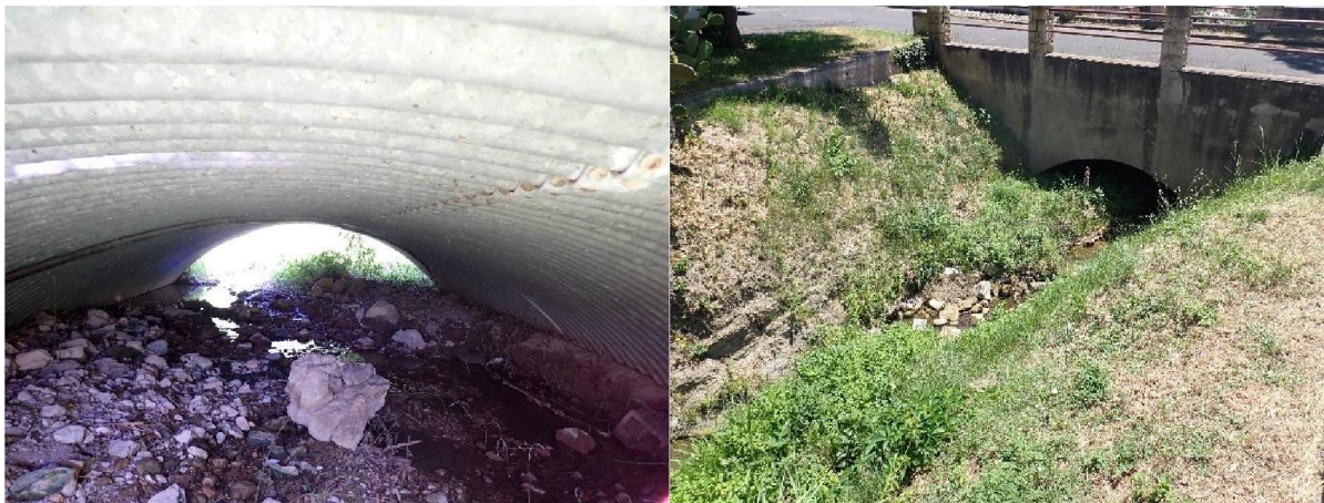
Vues de l'ouvrage obstrué
